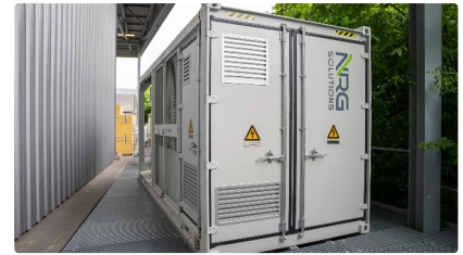
Système de stockage SABAG, Rothenburg (LU)
