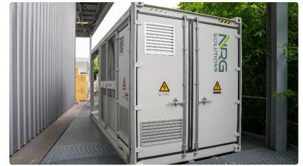
Batteriespeicher SABAG, Rothenburg (LU)
